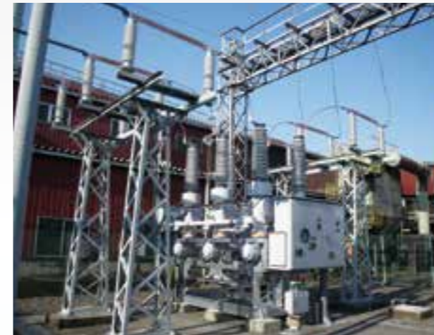
特高受配電設備
