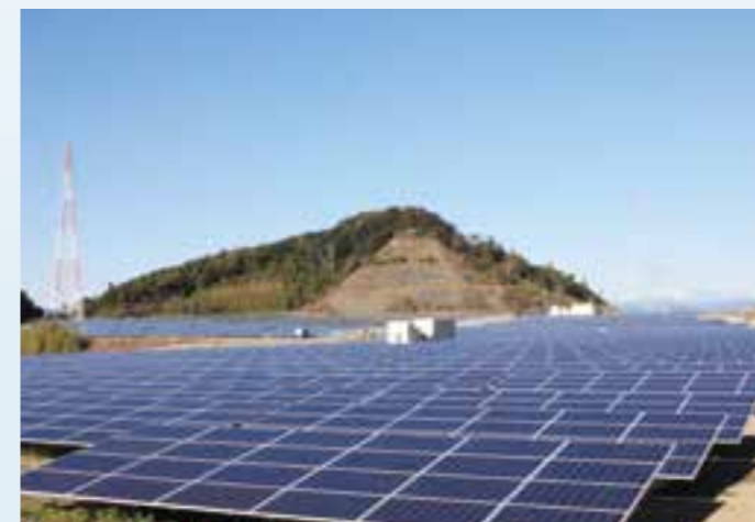
架台設置型太陽光発電システム
