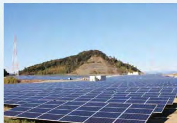
架台設置型太陽光発電システム
