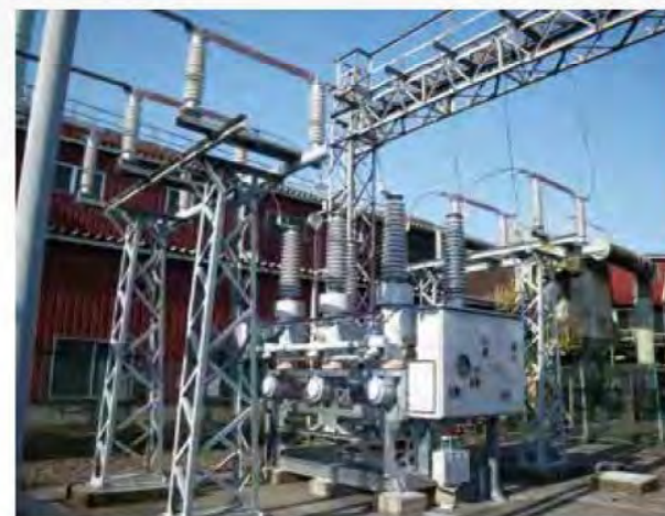
特高受配電設備
