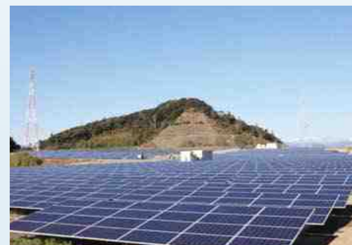
架台設置型太陽光発電システム
