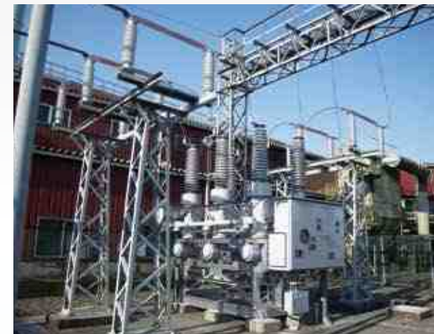
特高受配電設備
