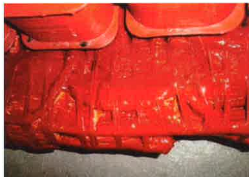
発電機絶縁回復(ワニス処理)
