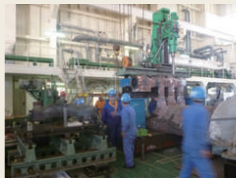
海外火力発電所
