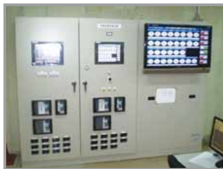
同左 電力監視システム
